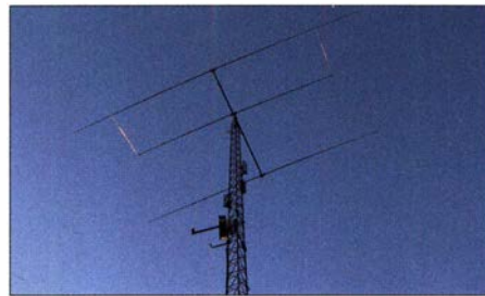
Die neue Yagi-Antenne für 15805 kHz war bis Mitte August in Richtung Norden ausgerichtet und zeigt nun nach Süden.
